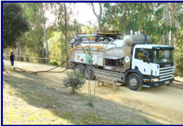
Camión de limpieza de alcantarillado
